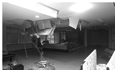
被災したデイルーム
